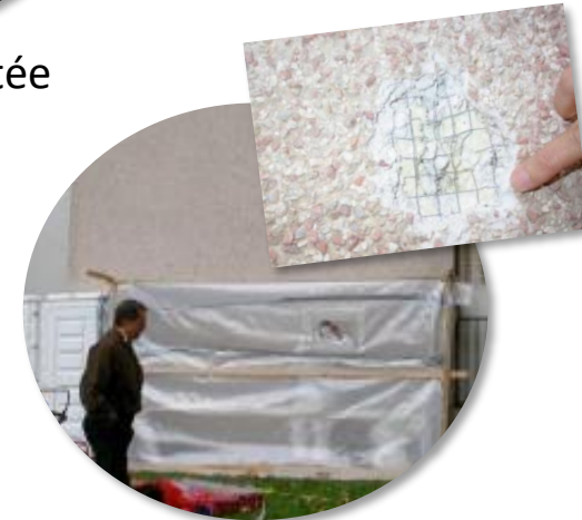
Bourre d'amiante sous un revêtement d'aspect béton lavé
