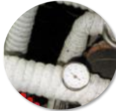
Calorifugeage à base de tresse amiantée
