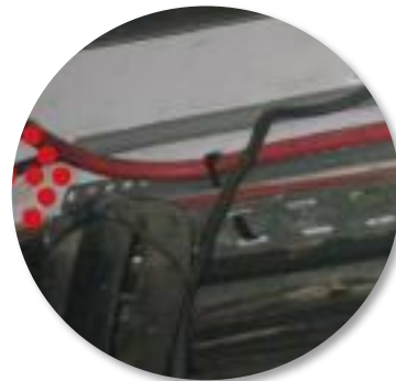
Gaines des câbles électriques
