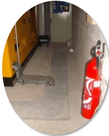
Plaques de protection des caniveaux techniques
